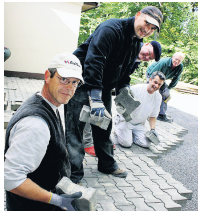
Packen's an: Ralf Todt (von links), Jörg Bechtel, Manfred Schmidt, Peter Kleine und Dieter Lechtenfeld verlegen die ersten Pflastersteine für den neuen Vorplatz. FOTO: A. MARIC
